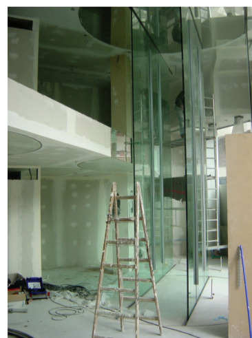
  Los paneles recorren la doble altura del espacio principal.
